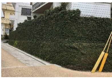
オオイトビ等によるブロック塀の壁面緑化（那覇市・当蔵）
